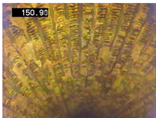
目詰まりしたスクリーン（斜視）
